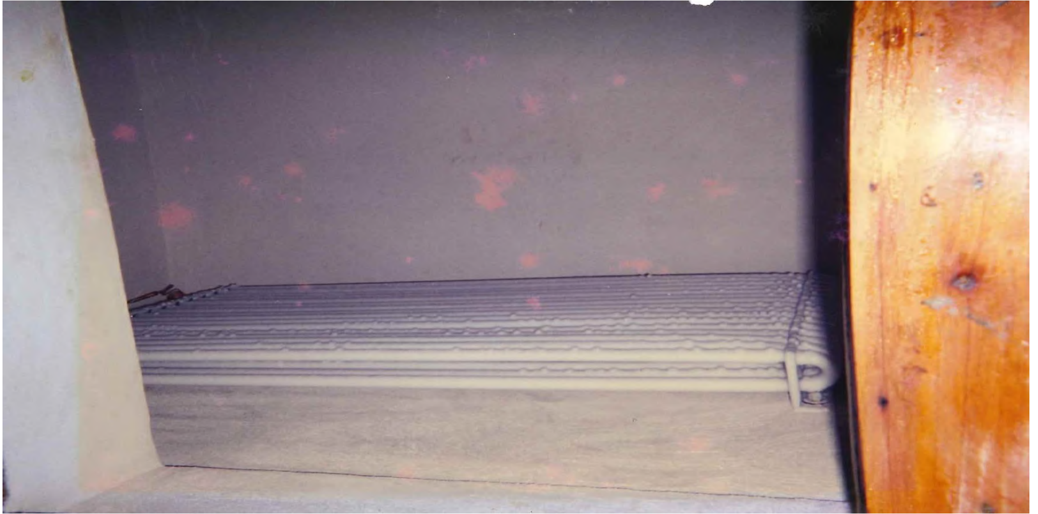
Câmara fria em funcionamento. 1997
